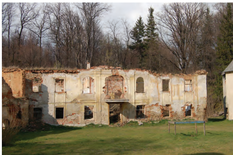
Obr. 4 Dvorní průčelí zámku po zřícení části budovy, stav 3. dubna 2008 (foto autor)
