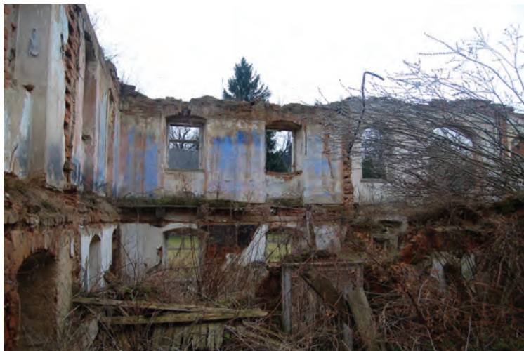
Obr. 5 Interiér východní části zámku po zřícení stropních konstrukcí a většiny příček, stav 14. února 2008 (foto autor)
